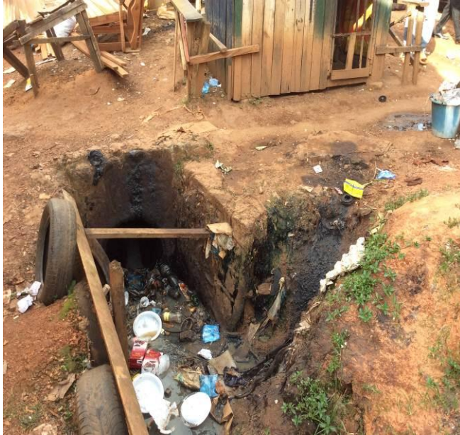
Fig. 12 : bouchage des voies d'écoulement des eaux Briqueterie-Yaoundé
