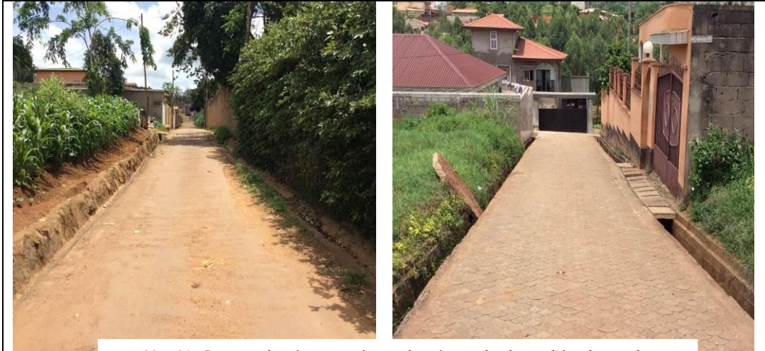
Fig. 30 et 31 : Routes en bon état marquées par la présence des drains d'écoulement des eaux de surface. A gauche, rigole et en perré-maçonnerie et cunette A droite, rigole en béton armé
