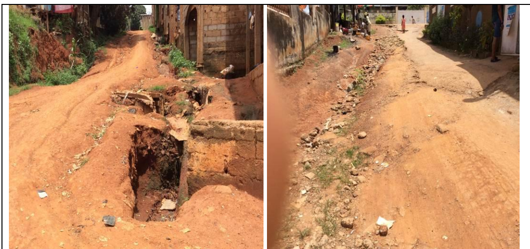
Fig. 22 et 23 : Routes en piteux état marquées par l'absence des drains d'écoulement des eaux de surface. A gauche, route en terre dégradée A droite, route en revêtement de bicouche dégradée
