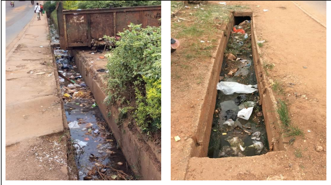
Fig. 25 et 26 : Manque d'entretien des drains de la ville de Yaoundé A gauche, au quartier Biyem-assi et à droite, au quartier Elig-effa
