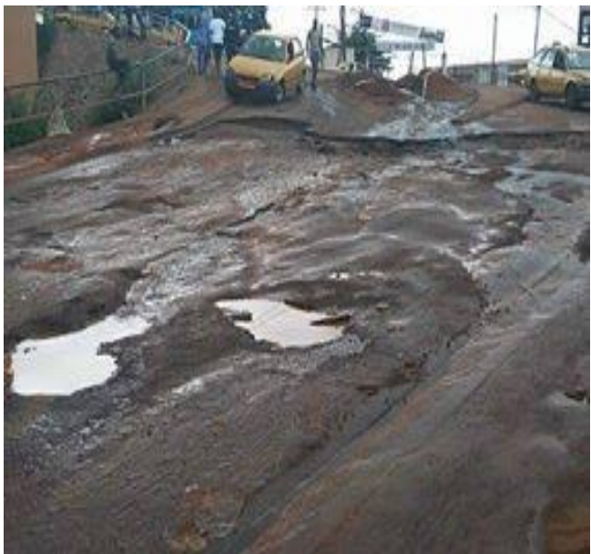
Fig. 13 : dégradation des chaussées du au ruissellement des eaux de surface
